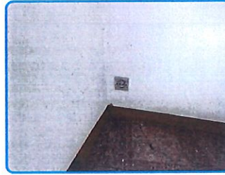
Anomalie B.3.3.6 a1 sur Install. n°1
