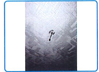
Anomalie B.8.3 a sur Install. n°1
