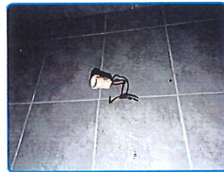
Anomalie B.8.3 b sur Install. n°1 Anomalie B.6.3.1 a sur Install. n°1 App. n°2
