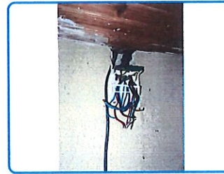
Anomalie B.8.3 e sur Install. n°1
