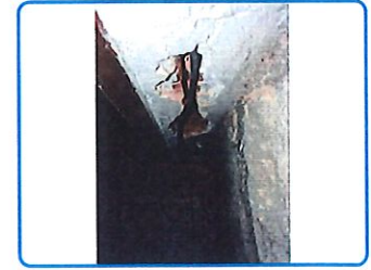
Anomalie B.6.3.1 a sur Install. n°1 App. n°1
